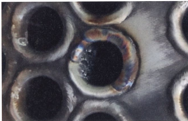
Bild 4: Beispiel Wärmetauscher – Undichtheit / Blasenbildung
